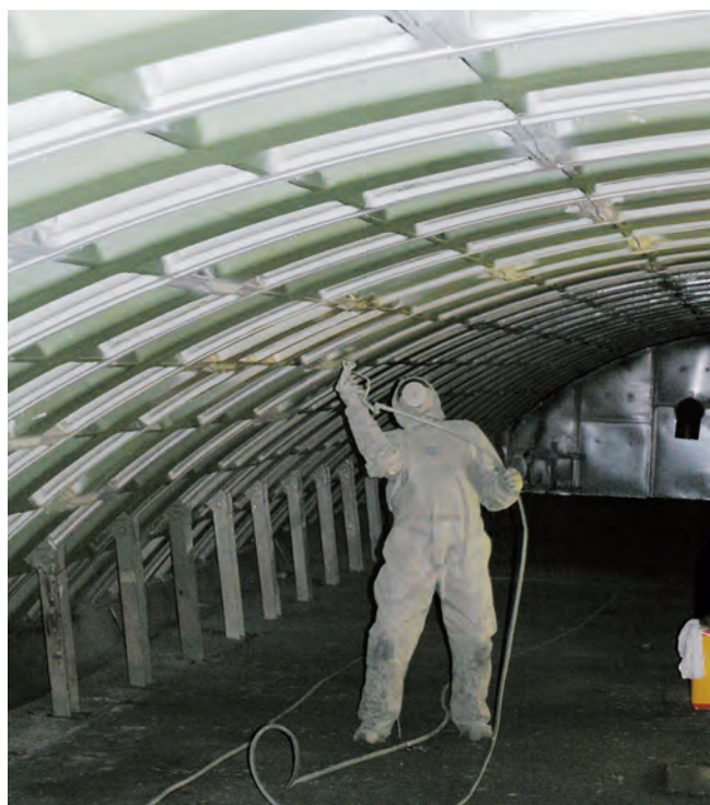
Das IPA untersuchte gemeinsam mit der BG BAU die Belastung der Beschäftigten auf aromatische Amine bei den Sanierungsarbeiten im Elbtunnel.
