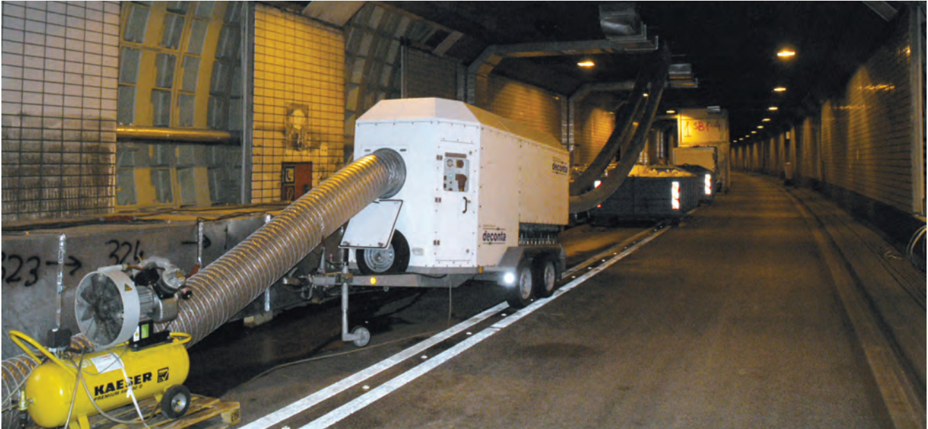
Die Mitarbeiter benötigten bei den Sanierungsarbeiten maximalen Schutz. So war die Belüftung der Teilabschnitte besonders aufwändig.
